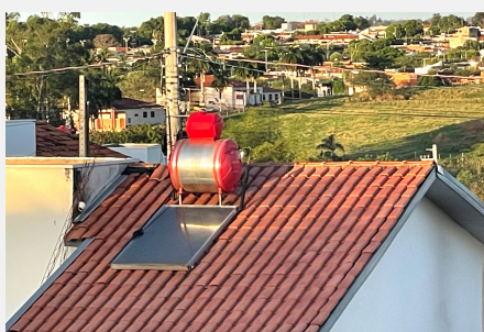
Figura 5: Exemplo de sistema de aquecimento elétrico solar.
