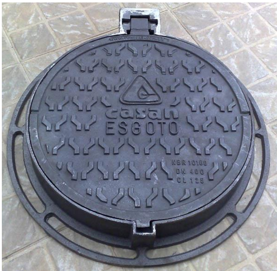
Figura 4. Tampão instalado no nível do pavimento para dar acesso ao PV.
