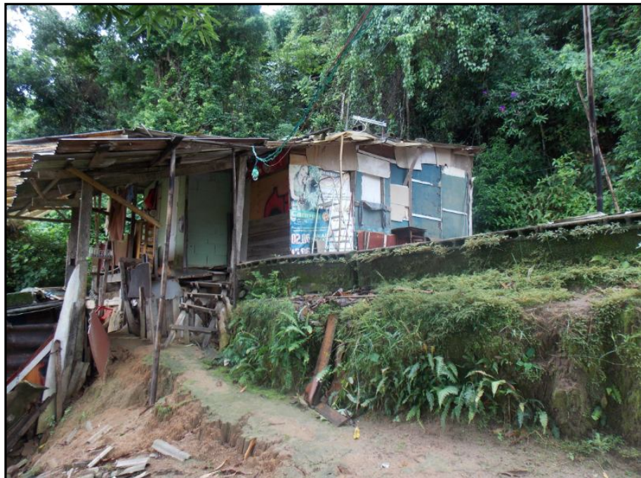
Figura 6: Canta Galo, moradia em área de risco, 2015.
