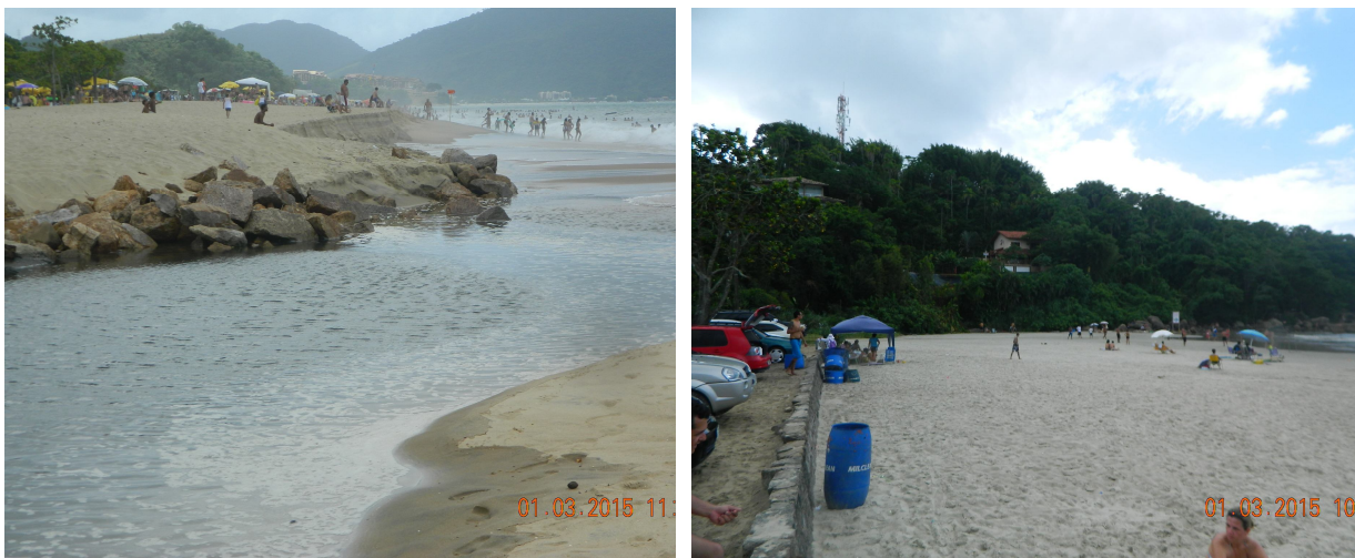
Figura 5A e B: Erosão costeira da praia do Massaguaçu - Caraguatatuba –SP. Fonte: Mercio Fabrício Souza Santos, 01/03/2015 (Arquivo Pessoal).
