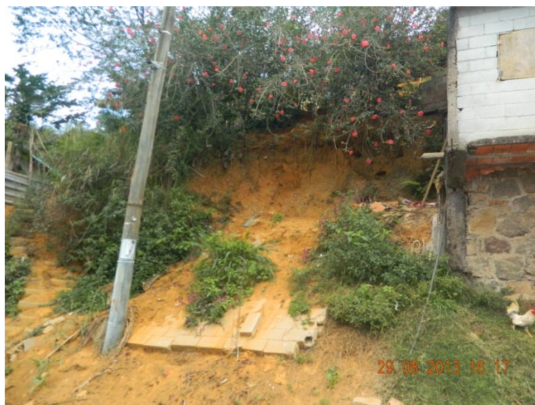
Figura 2: Erosão Continental no Bairro Bela Vista – Ubatuba-SP. Fonte: Mercio Fabrício Souza Santos, 29/08/2013(Arquivo Pessoal).
