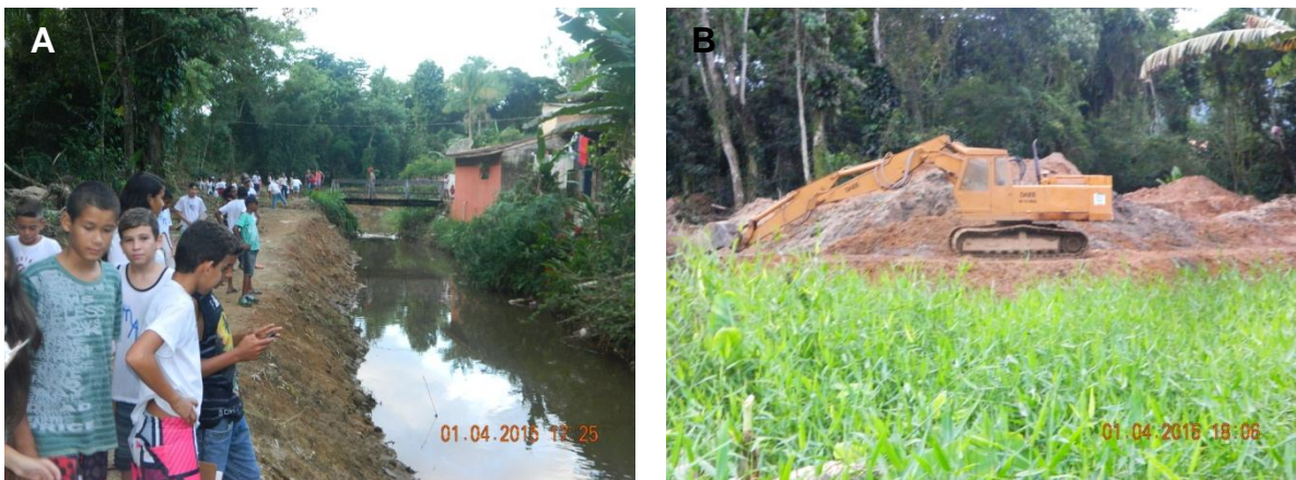
Figura 9A e B: Alteração do Canal do Rio da Lagoa, Ubatuba-SP. A: leito do rio com erosão, B: máquina acelerando processo erosivo.
