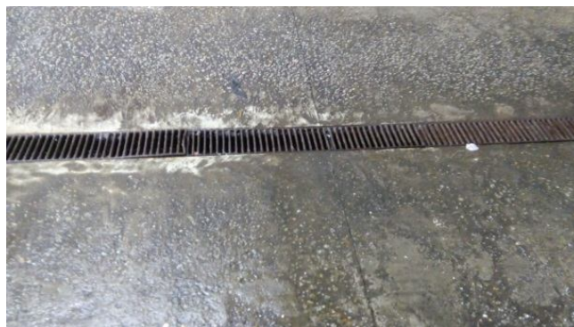
Figura 9: Grades do piso para coleta dos efluentes. Fonte: Acervo do Autor (2018).
