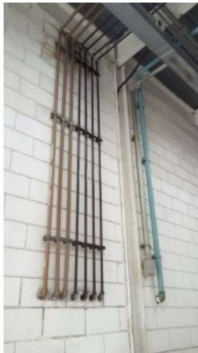
Figura 15: Instalações para a estrutura dos serviços de troca de óleo. Fonte: Acervo do Autor (2018).
