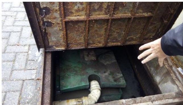
Figura 10: Caixa de coleta dos efluentes com bomba submersa e separadores de água e óleo. Fonte: Acervo do Autor (2018).
