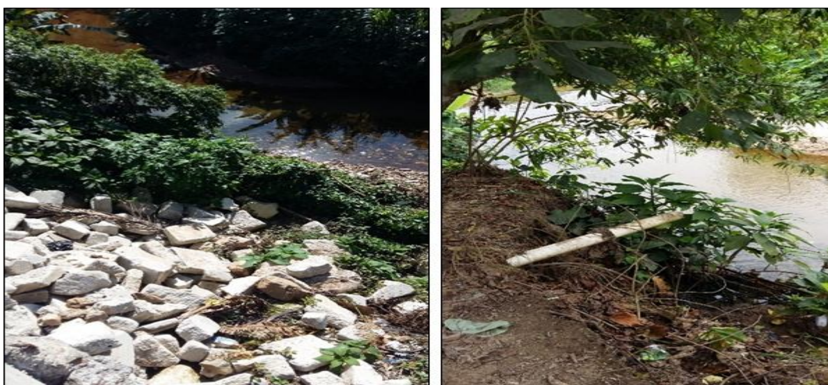
Figura 4: Fotos do Trecho 2 e 3 – Entulho e Esgoto clandestino.
