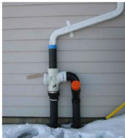
Figura 3: Desviador das águas das primeiras chuvas com válvula de desvio vertical.
