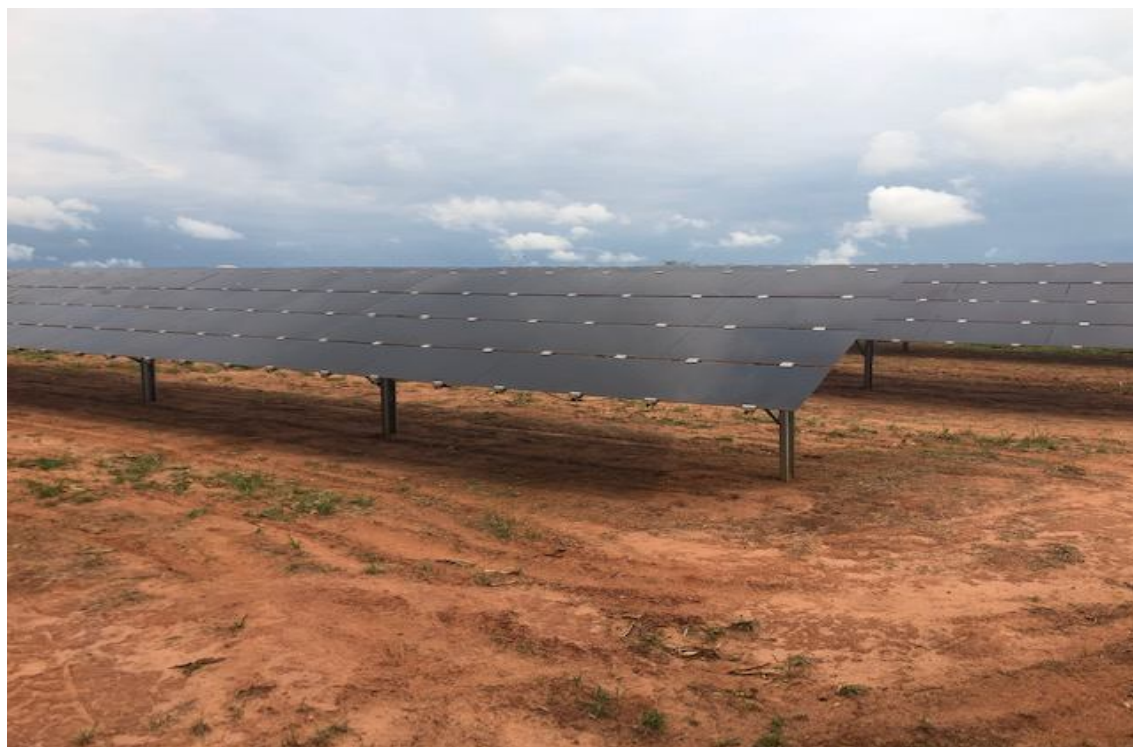
Figura 26: Usina Fotovoltaica de Fernandópolis – SP
