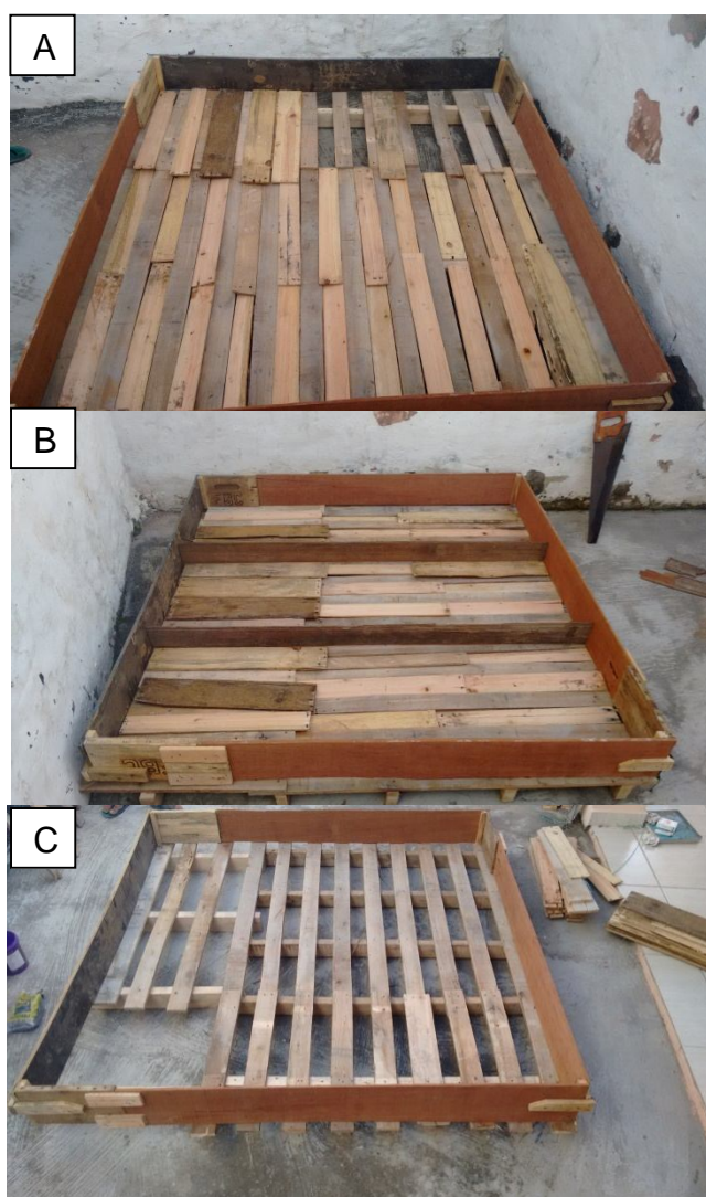
Figura 7A, B e C: A e B Fechamento do fundo do quadrado com pedaços de caixa de madeira. C: Suspensão do quadrado sobre os paletes.
