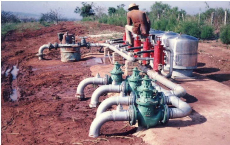
Figura 22b Irrigação localizada – “Cabeçal de controle”. Fonte: Frizzone (2014).
