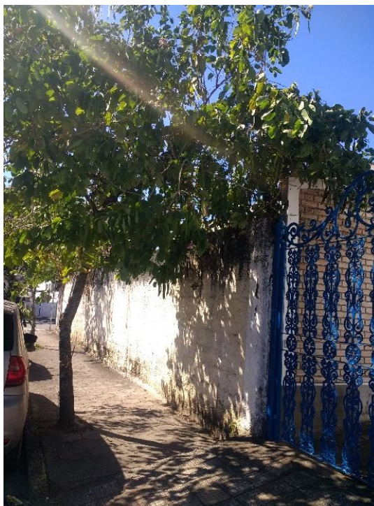
Figura 31: Bauhinia sp. adulta plantada na Rua Avelino Ferreira apresentando conflito com muro e portão de duas residências. Fonte: a autora
