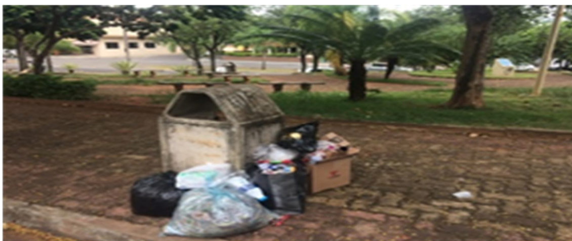
Figura 13 – Praça João Guzzo - Lixeiras de concreto sem manutenção. Fonte: A autora (2017).
