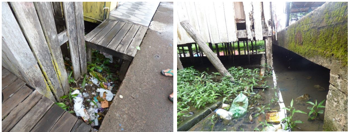
Figura 21. Alguns locais onde se encontram a rede de distribuição de água do município de Afuá – PA.
