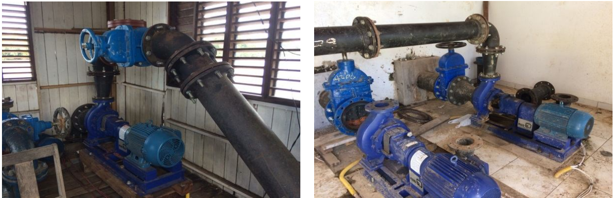
Figura 16. Bombas de captação e distribuição de água da ETA da COSANPA.
