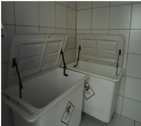
Figura 38: Contêiner no abrigo de Resíduos infectantes. Fonte: Próprio autor.
