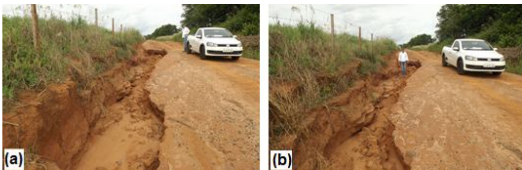
Figura 15 – Trecho da estrada rural após o período chuvoso – Sem pavimentação com RCC:(a); (b) Fonte: Próprio autor, 2017.
