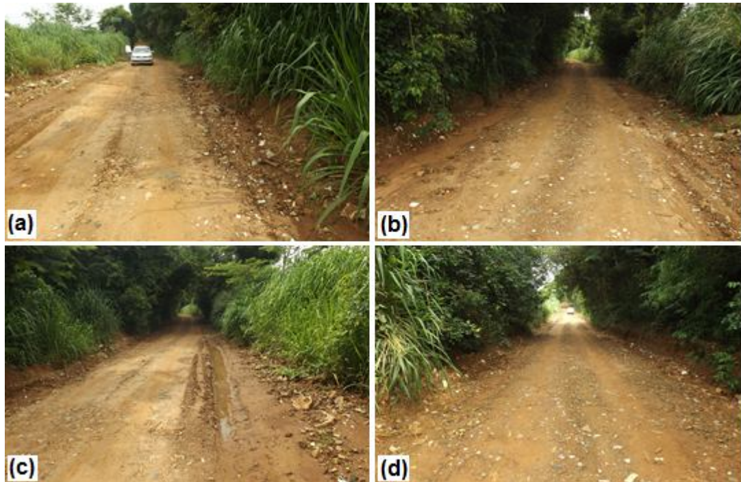
Figura 14 – Trecho da estrada rural pavimentada com RCC após o período chuvoso – (a); (b); (c); (d) Fonte: Próprio autor, 2017.
