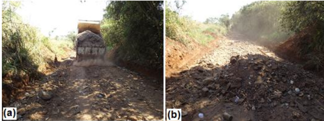
Figura 12 – RCC transportado até o local - (a): Caminhão depositando o RCC; (b): RCC depositado para início do nivelamento. Fonte: Próprio autor, 2017.
