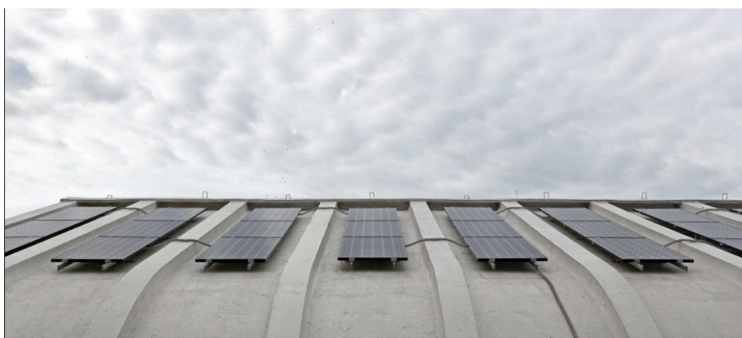
Figura 16 – Biblioteca Parque Estadual – Placas fotovoltaicas. Fonte: RIO DE JANEIRO, RJ (2016).
