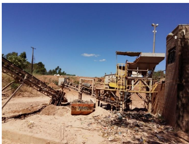
Figura 30: Interior da usina de reciclagem Mejan Ambiental, Fonte: O autor, 2016.
