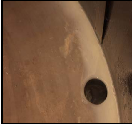
Figura 6: Falhas de Higiene no interior do tanque.
