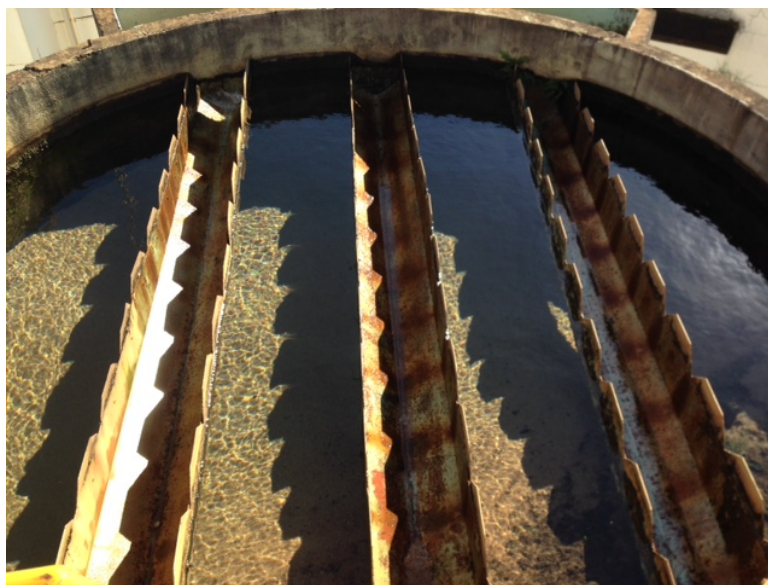
Figura 5 – Vista superior do filtro antes da realização da limpeza.
