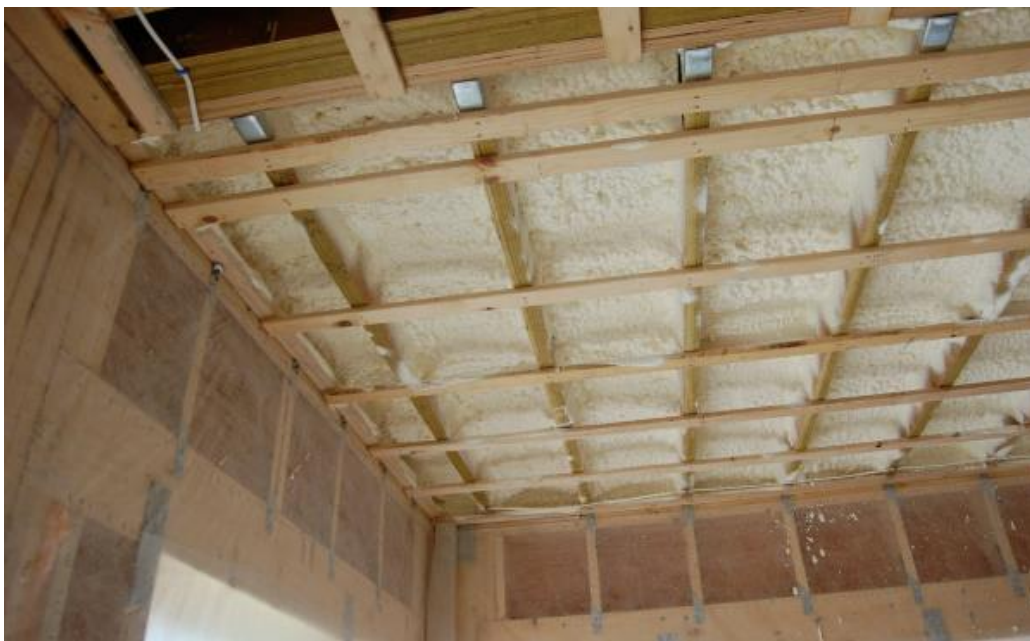
Figura 18: Instalação das mantas ou lãs isolantes térmicas. Fonte: Revista Técnica PINI – Edição 161 – Agosto/2010.
