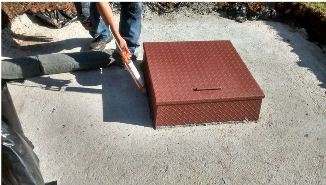
Figura 23: Caixa de acesso à cisterna. Fonte: ABCP (2017)
