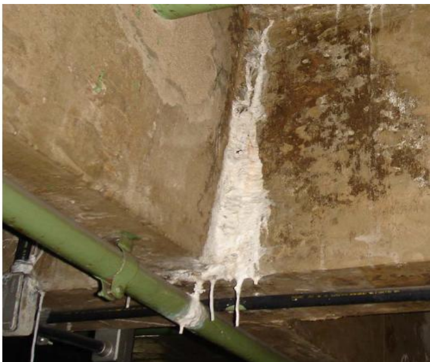
Figura 6 - Eflorescência em encontro de vigas em pavimento de garagem. Fonte: Souza (2008)
