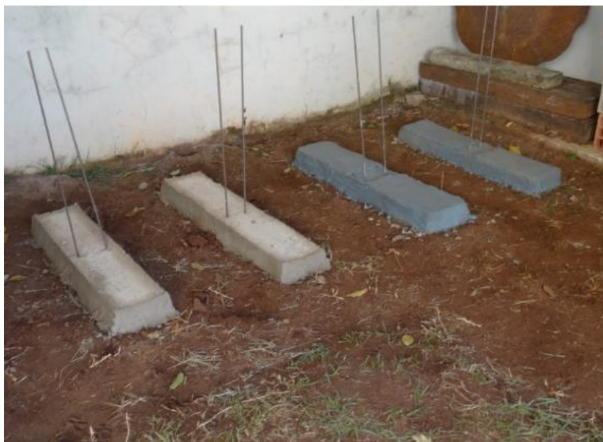
Figura 41 – Baldrames sem impermeabilização ao lado dos impermeabilizados que apresentam coloração diferente, mais escura.
