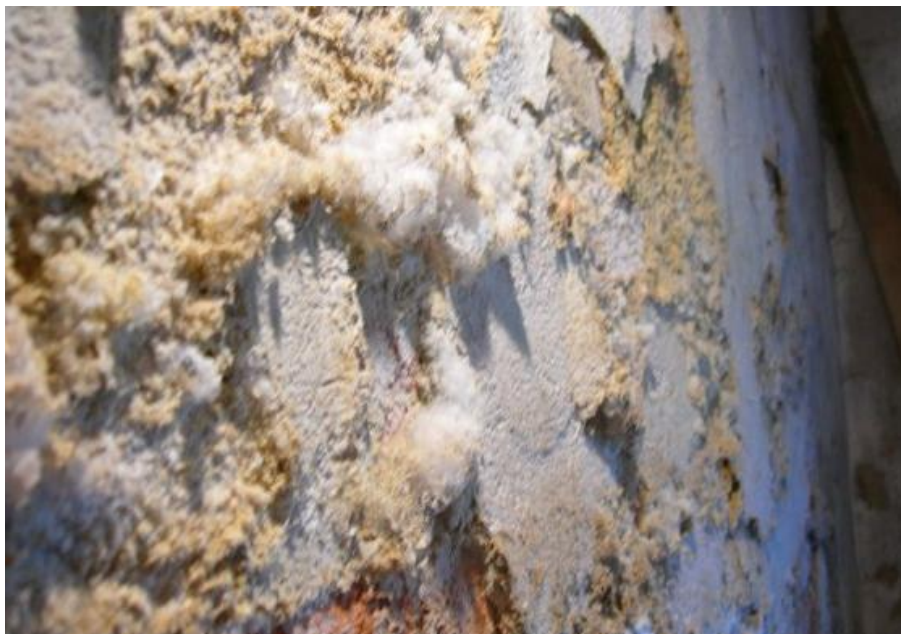
Figura 7 - Criptoflorescência em parede. Fonte: www.engenhariacivil.com
