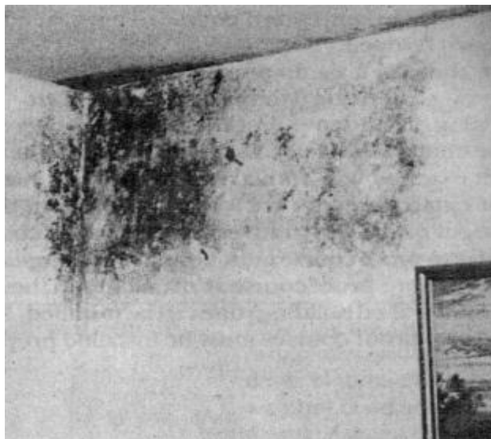
Figura 2 – Mancha de Umidade por Condensação Superficial Fonte: Santos et al. (2013).
