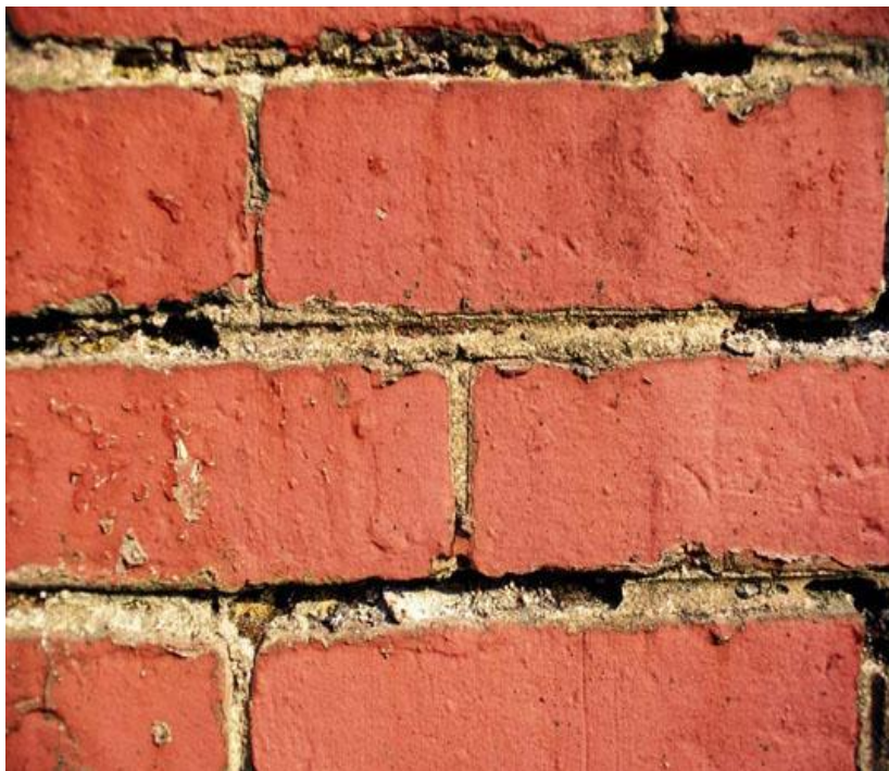
Figura 3: Umidade a degradar tijolos. Fonte: Santos et al. (2013)
