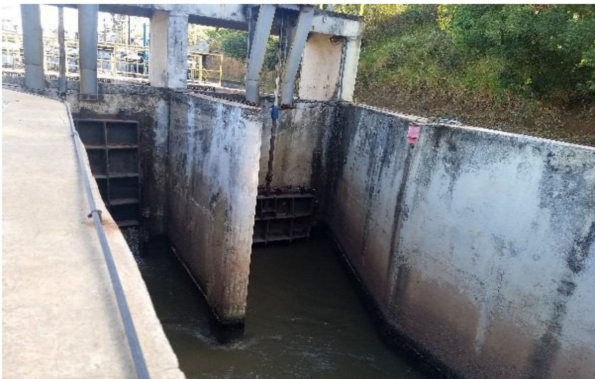
Figura 3 – Chegada do esgoto - ETE Uberabinha, DMAE.
