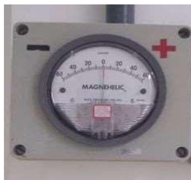
Figura 23 - Foto do manômetro inoperante do leito de precaução aérea do CTI
