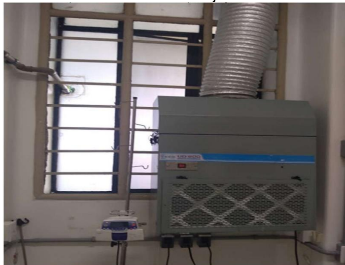
Figura 26 - Ausência de estanqueidade nos leitos de precaução aérea, devido a abertura da janela
