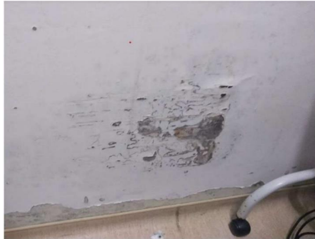
Figura 27 - Parede do Leito de precaução aérea com deterioração física nas instalações e presença de fungos
