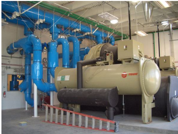
Figura 5: Central de água gelada.
