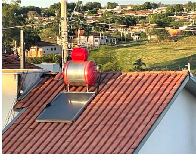
Figura 4 – Sistema de aquecimento elétrico solar.
