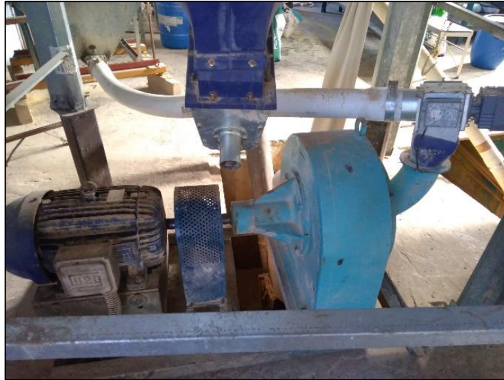
Figura 6 - Conjunto moinho de martelos, motor elétrico e tubulações no espaço físico da fábrica, na fazenda Santa Maria, município de Itobi/SP
