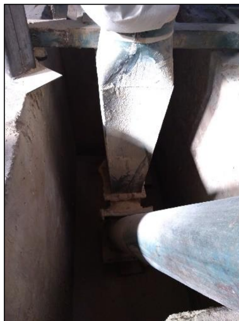
Figura 7 - Tubos de saída de grãos moídos do moinho e de transporte para silo de armazenamento, através de rosca helicoidal, no espaço físico da fábrica, na fazenda Santa Maria, município de Itobi/SP
