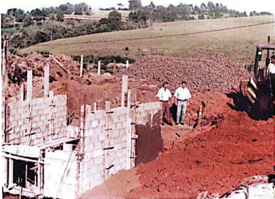
Estação de Tratamento de Esgoto, 100% coletado e tratado.
